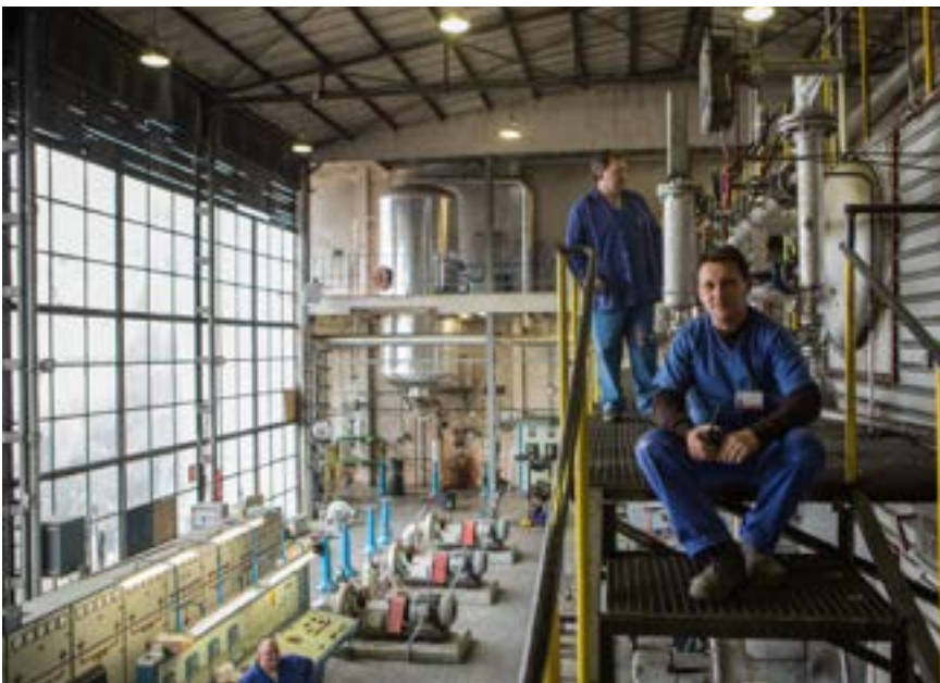
Central térmica construida en 1969 para dar servicio de calefacción, agua caliente sanitaria y vapor de agua al hospital. Tras más de 40 años en funcionamiento, fue renovada por una de gas natural en el marco del Plan de Eficiencia Energética del Servicio Madrileño de Salud.
