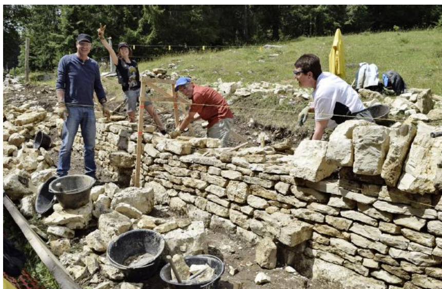
Wiederaufbau einer freistehenden Trockenmauer in La Sagne im Kanton Neuenburg. Foto: Stiftung Umwelteinsatz Schweiz.
