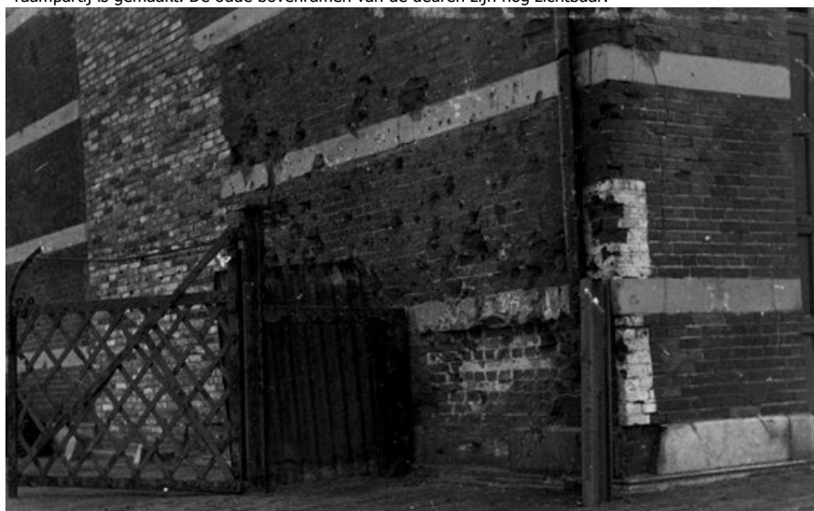
Afb. 2.4.7 Oorlogsschade door beschietingen, in de westgevel van de westvleugel, foto september 1945.
