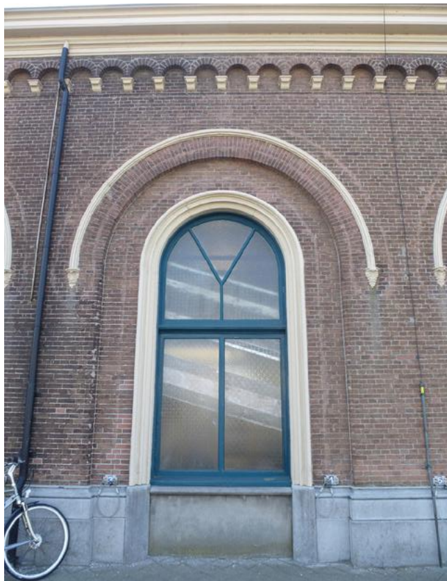
De kozijnen en de roedeverdeling van alle vensters en deuren zijn niet meer origineel. Sommige deuropeningen zijn vervangen door een raam (herkenbaar aan het kleurverschil van het natuursteen in de plint).
