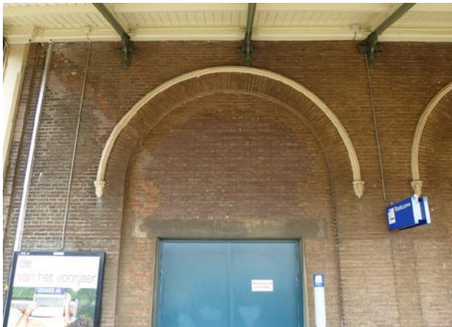
Slecht één rondboogvenster is deels dichtgemetseld en vervangen door een reguliere deur (geheel links in de achtergevel), de rest is nog intact.
