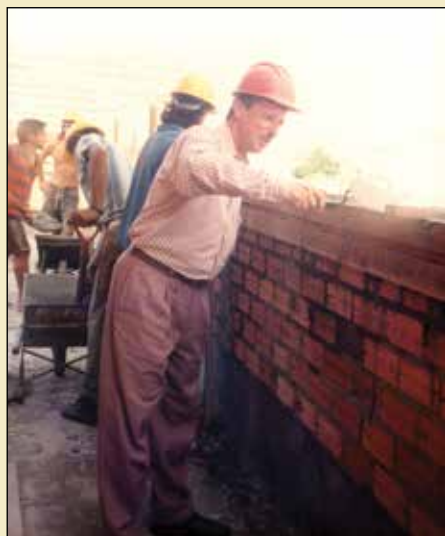
Nilson Luiz May "trabalhando" nas obras da nova sede da Unimed Federação, 1993.
