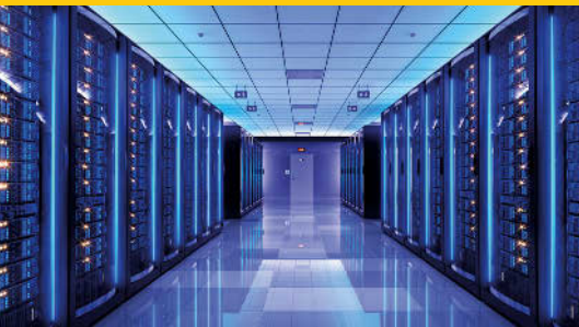
DATA CENTER / RECHENZENTREN
