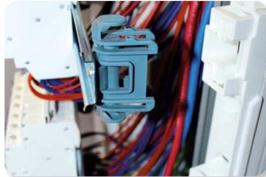
Rail DIN positionné sur un axe rotatif, pour faciliter le passage des câbles.
