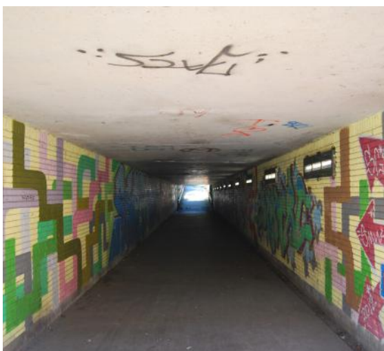
Tunnel interwijkverbinding niet sociaal veilig.
