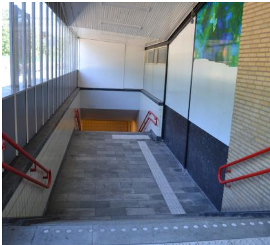
Stationstunnel niet toegankelijk voor rolstoelgebruikers. Geen voorzieningen gekoppeld aan tunnel.
