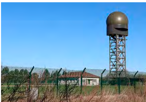
Le radar de surveillance GM403 de l'armée a été installé l'an dernier. © l'Hebdo du Vendredi
