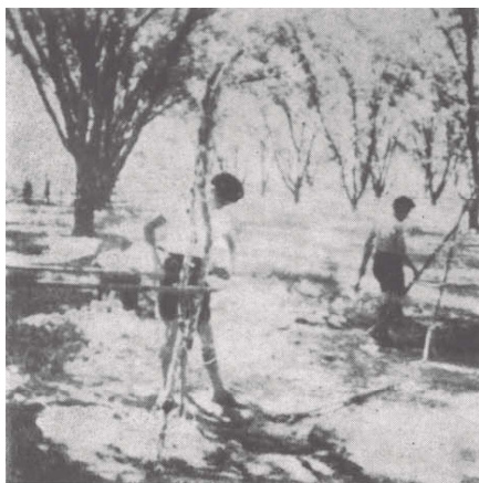
Empezando sus construcciones los muchachos del grupo V en el Campamento Scout de Provincia en La Nogalera, en octubre de 1957.
