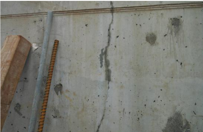
Fig. 3: El agrietamiento en esta estructura de concreto puede tener un impacto significativo en su durabilidad.
