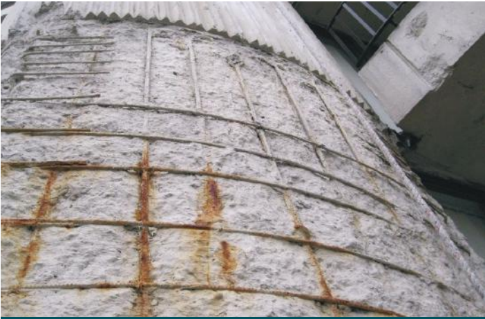
Fig. 2: Corrosión prematura del acero de refuerzo debido a un recubrimiento de concreto inadecuado
