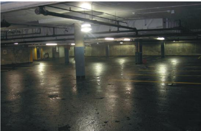
Fig. 4: Una estructura de estacionamiento subterráneo con impermeabilización.
