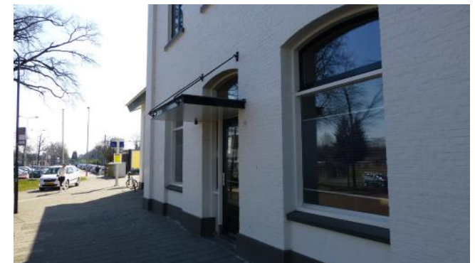
40. Gevel middengedeelte, voorzijde. De luifel is in de jaren zeventig aangebracht. STEENHUISMEURS 39
