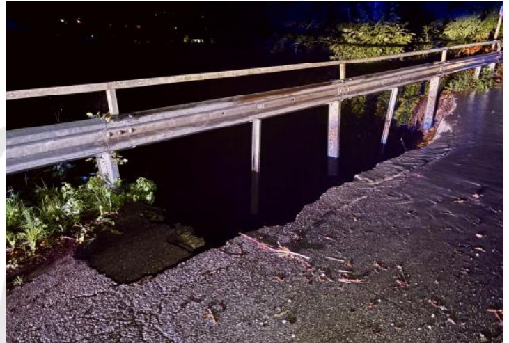
Abgebrochene Fahrbahn durch Unterspülung
