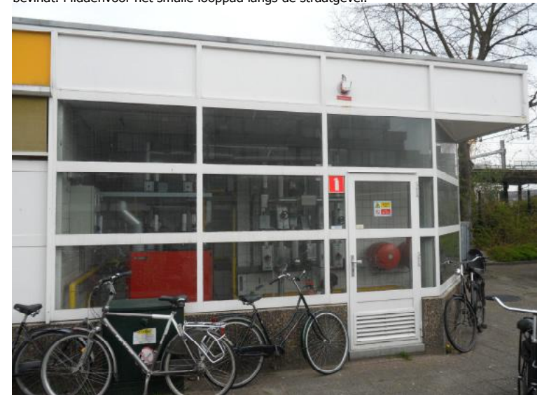
Afb. 5.5.12 De technische ruimten in de oostelijke aanbouw.
