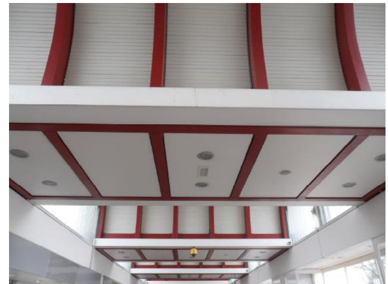
Afb. 5.6.2 De vlakke plafonddelen zijn ingevuld met trespa-platen. De ritmiek van de dakconstructie loopt door in de vlakke plafonddelen in de stationshal.
