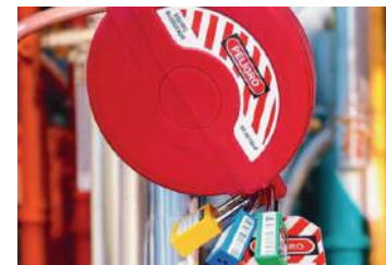
BLOQUEO DE VÁLVULAS
