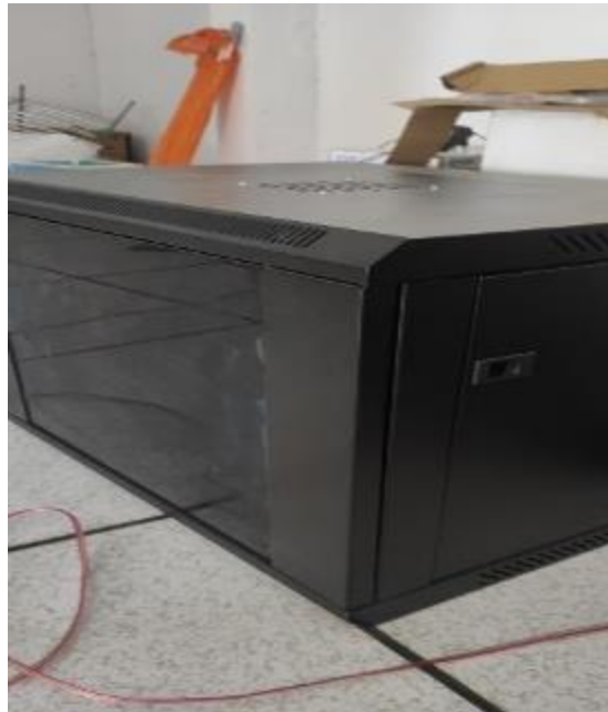
Gambar 3.6.2. Rack Perangkat Jaringan
