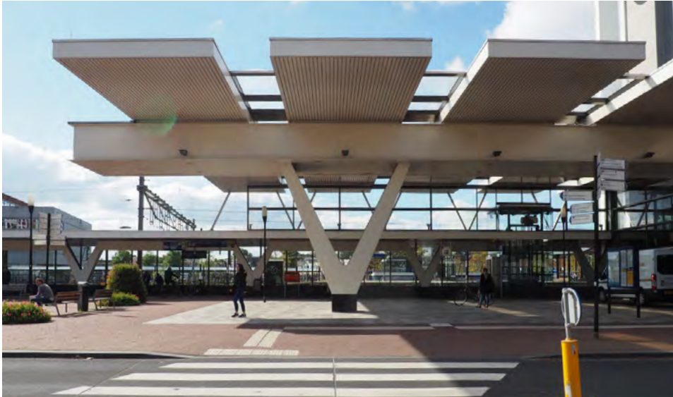
Overgedimensioneerde gebouwonderdelen ter plaatse van de hoofdingang
