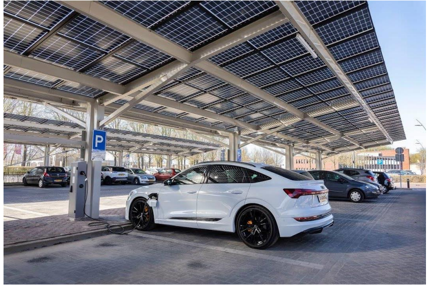
Figuur 1 Voorbeeld van een Solar carport op het parkeerterrein van het gemeentehuis Dronten
