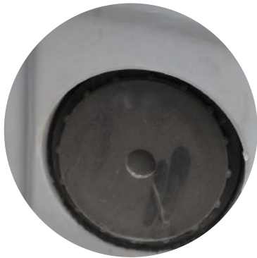
Ducto para el suministro de agua
