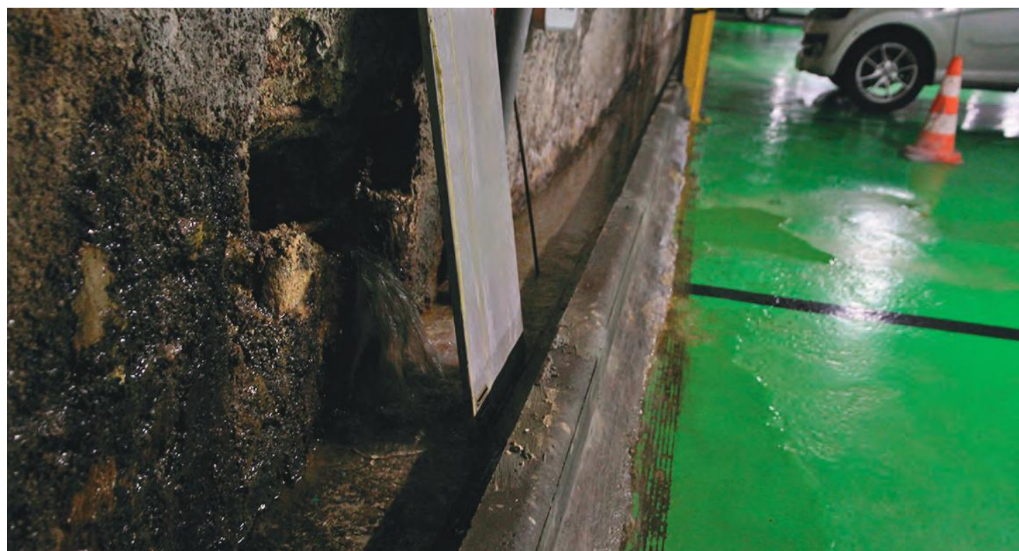
Les moisissures et les fuites d'eau sont légion aux niveaux -2 et -3 du parking souterrain. © l'Hebdo du Vendredi
