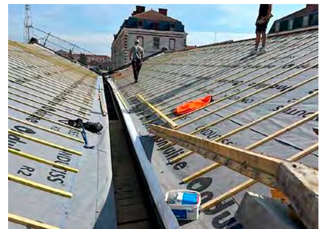
Près de 300 000 € sont consacrés à la réfection du toit du dépôt archéologique, quartier Chanzy. © Drac Grand Est
