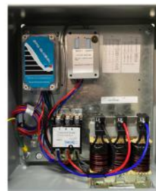
50kA (Protección de Motor)
