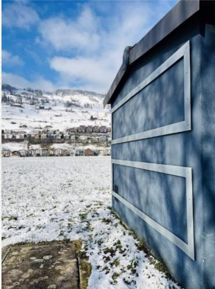
Foto 8: Trafo-Station, blinde Fenster, Symmetrie und Horizontale, 2007, verzinkter Stahl, Farbe, von Christian Kathriner
