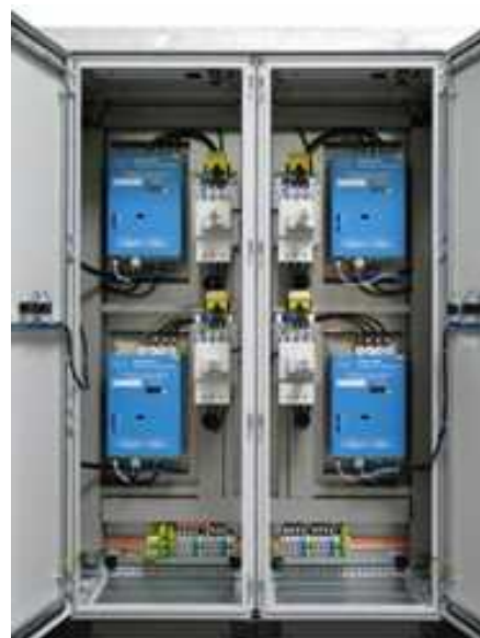
Abb. 5-10 Schaltschrank mit vier Invertern
