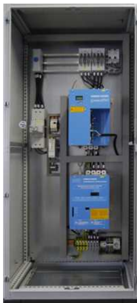
Abb. 5-9 Schaltschrank mit Master / Slave
