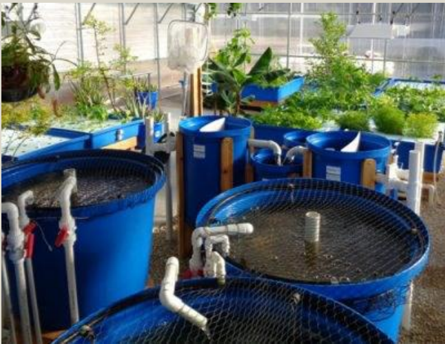
Example of mechanical filter— Nelson Pada .
