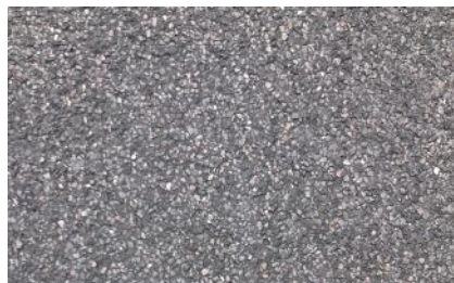
Revêtement bitumineux, standard. Après exposition aux UV (2-4 ans).
