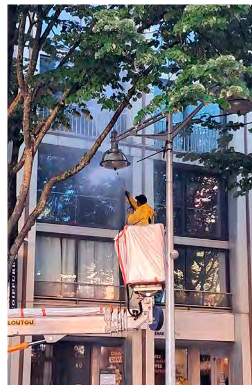
La maintenance des 46 candélabres comprend le remplacement des fournitures et le nettoyage des mâts. © l'Hebdo du Vendredi
