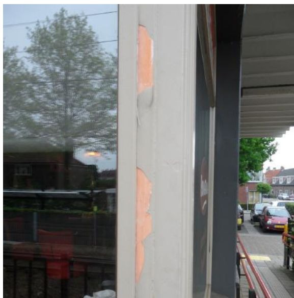
Afb. 5.17 Achterstallig onderhoud aan het kozijnwerk bij de hoek perrongevel/ zuidelijke kopgevel.
