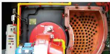
Control de Recipientes a Presión - Calderas
