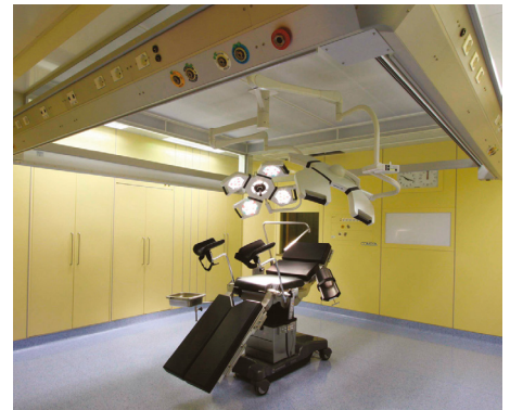
Photo : plafonnier salle d'opération classe ISO5
