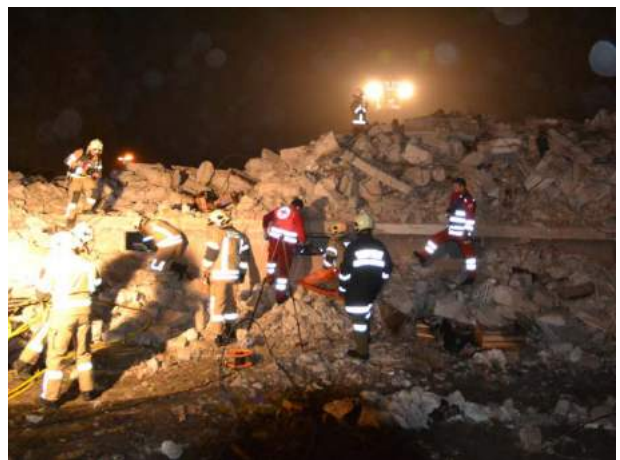
28. November – Verschüttete Personen nach Gasexplosion
