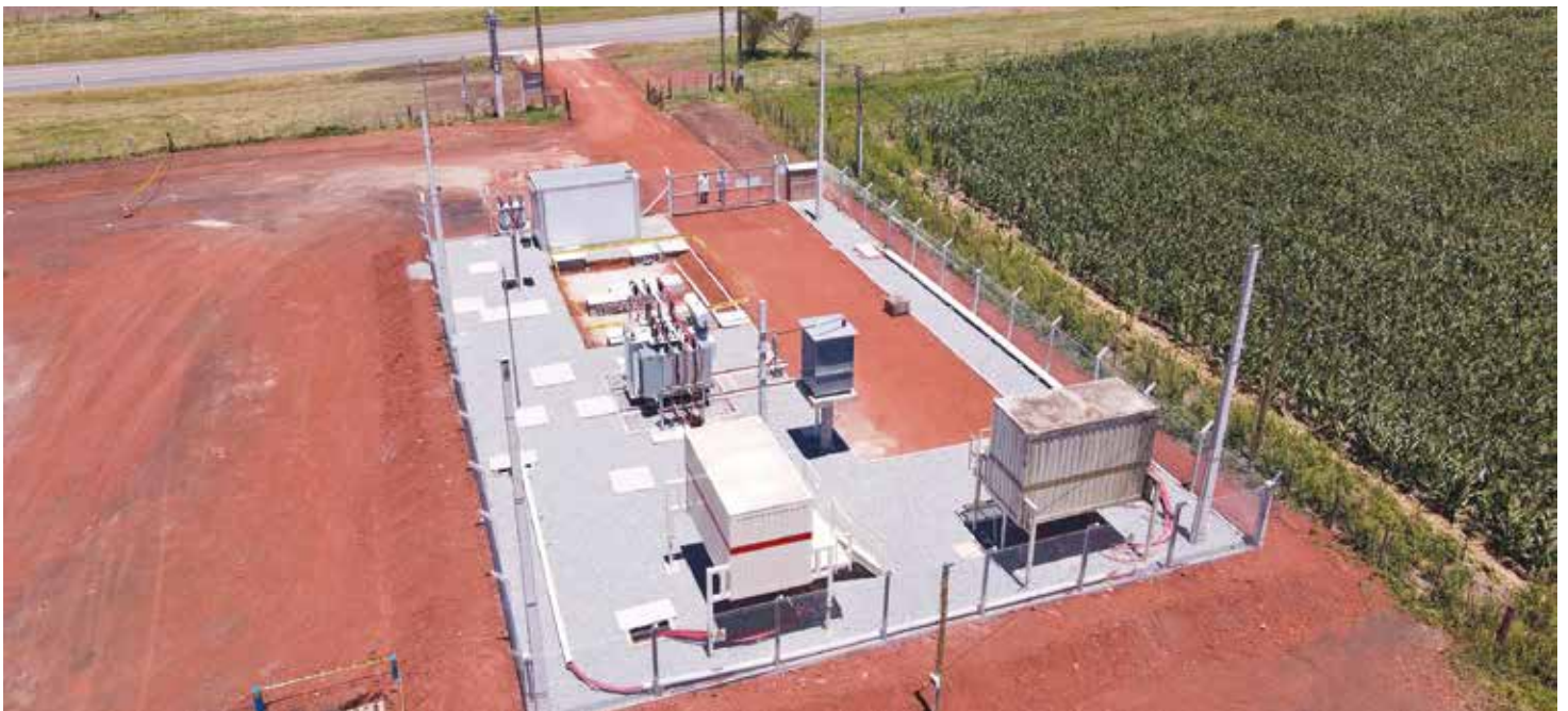
El predio donde está ubicado el final de la línea de UTE, con la transformación correspondiente, en ruta 14, departamento de Soriano
