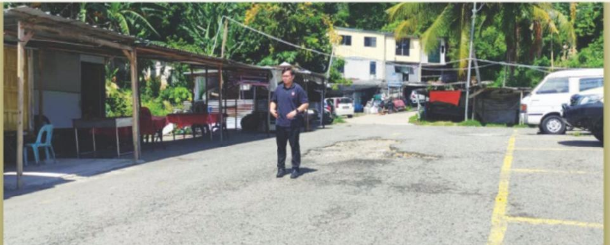
Pemeriksaan jalan rosak di Kampung Kopungit pada 28 Mei 2024.
