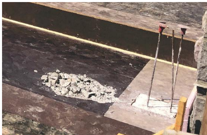
Fig. 4: Durante una visita al sitio, el ingeniero giró instrucciones al contratista de despostillar el concreto de la columna sobre la cimbra del plafón. Si este requerimiento es necesario, necesita estipularse en los documentos del contrato.
