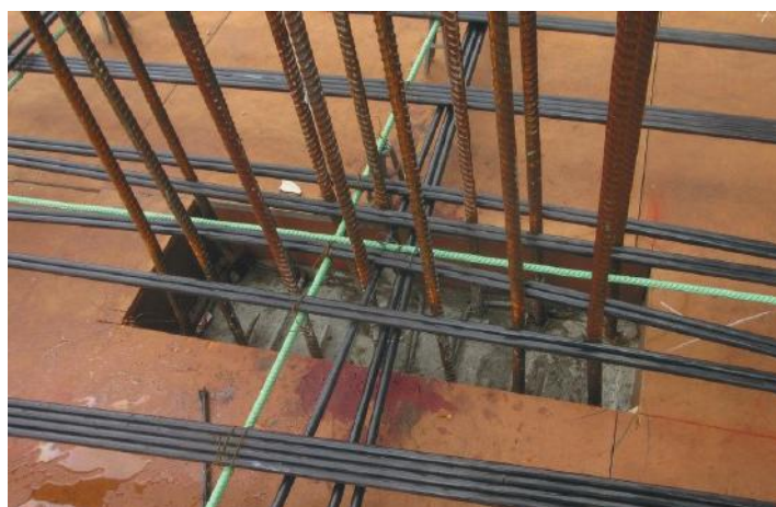
Fig. 2: En este proyecto, el ingeniero le solicitó al contratista que colocara el concreto de la parte superior de la columna 4 pulgadas (100 mm) por debajo del plafón de la losa.
