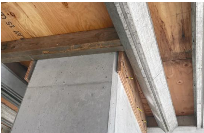
Fig. 3: Sostener la parte superior de la columna por debajo de la losa complica la cimbra, requiriendo agregar cimbras laterales extra en la parte superior de la columna. Esto incrementa el costo, disminuye la productividad y puede dar por resultado filtraciones que podrían dañar el acabado de la columna y de la losa inferior.
