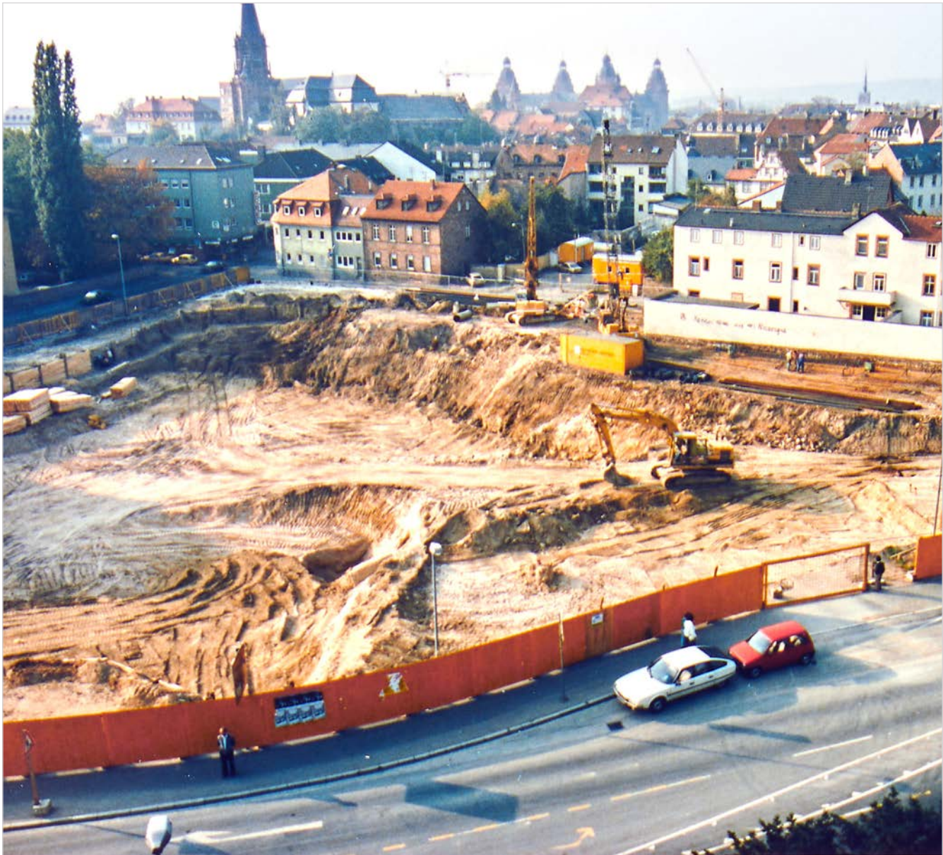
Mitte Oktober 1986 hatte man mit dem Aushub begonnen, die Baugrube musste allerdings noch sehr viel tiefer werden.
