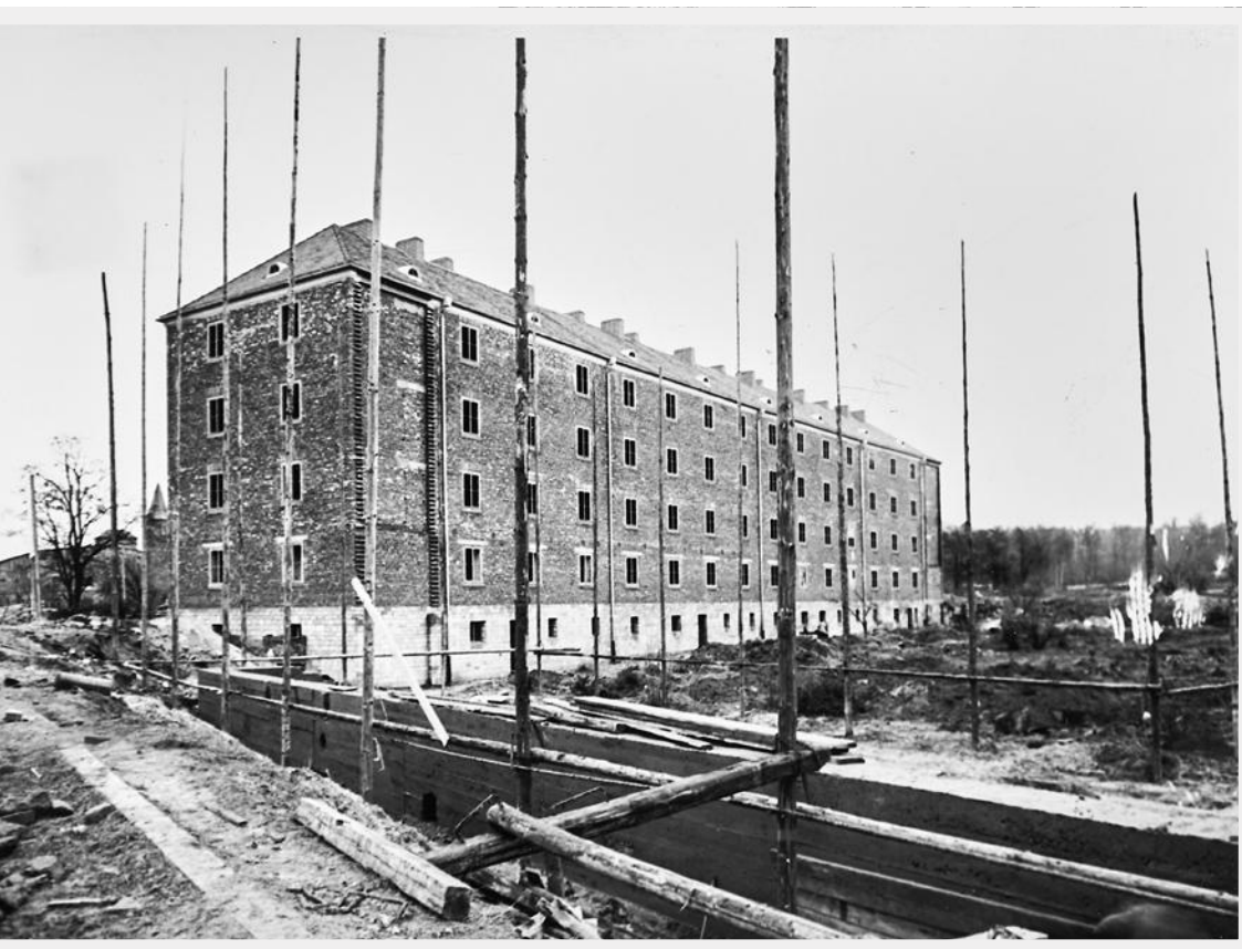
Rohbau am Hohenzollernring, begonnen 1949. Aufnahme 1950. Im Februar 1950, gegen Ende der Heizsaison, beschloss der Aufsichtsrat die Sammelbestellung der Öfen und Herde für die gesamte Anlage.
