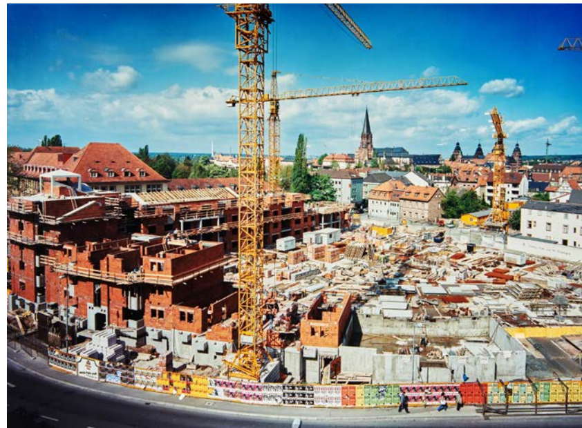
Nur zwei Monate später war bereits die erste Häuserreihe entlang der Werbachstraße aufgemauert.
