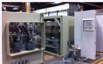
Armoire d'automatisme et contrôle — Moteur
