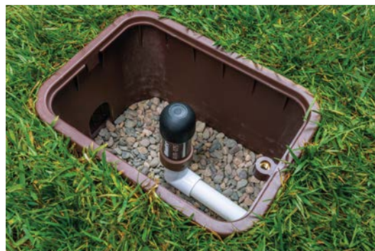
Válvula de alívio de vácuo/ar instalada
