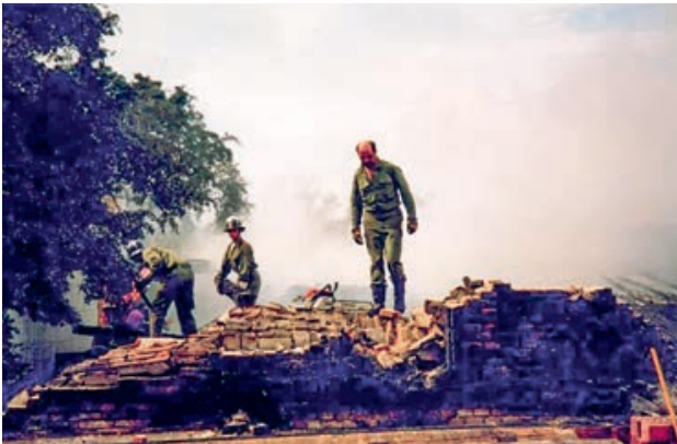
Aufräumarbeiten nach dem Brandereignis
