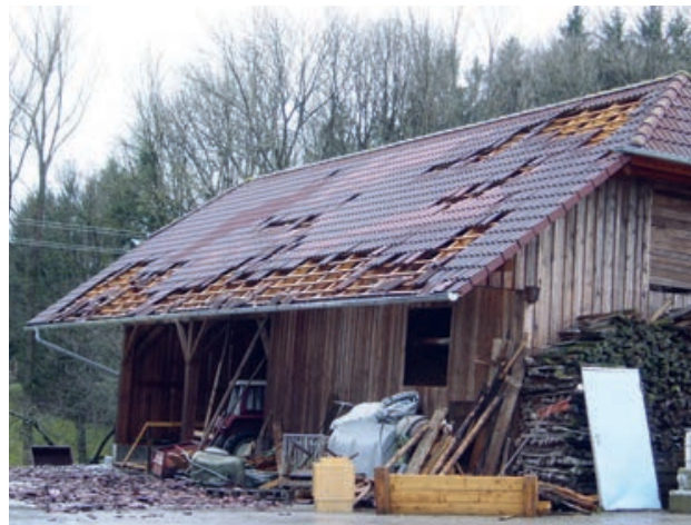
Abgedeckte Maschinenhalle durch Sturmtief Emma
