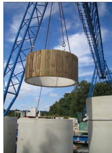
In de betonfabriek worden de beide gedeelten van de silo al samengevoegd.
