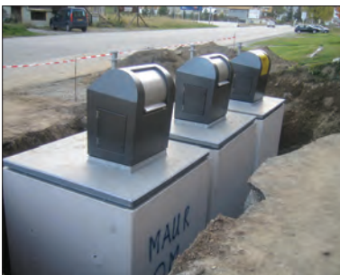
Tussen de kuipen is genoeg ruimte overgelaten om de grond aan te kunnen stampen.
