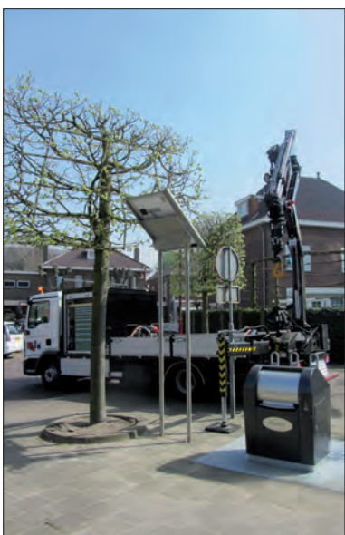
Service aan Solar perscontainer.
