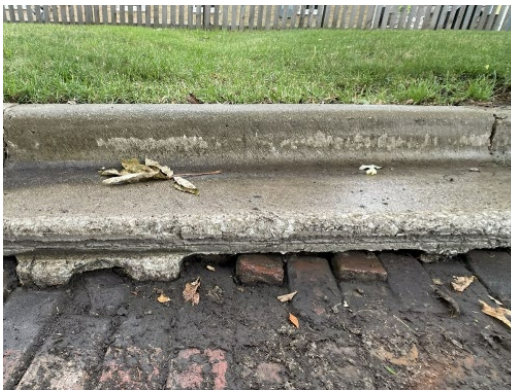
Edge Before Repair
