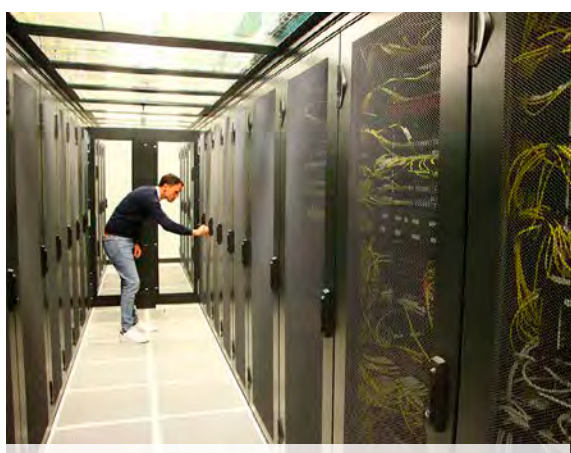
Agrandi de 140 m 2 , le datacenter compte 140 armoires. © l'Hebdo du Vendredi
