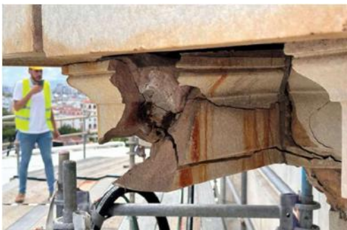
Los frisos ornamentales de la base de la cúpula muestran corrosión y grietas.
