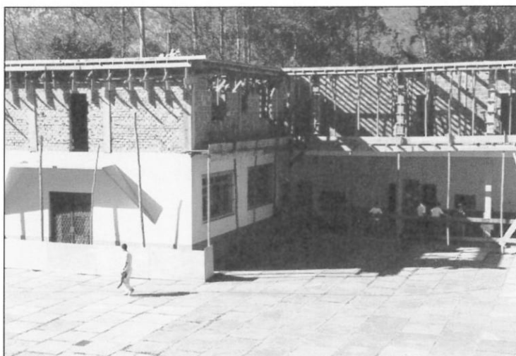
Il collegio "S. Agostinho" di Bom Jardim, durante i lavori di sopraelevazione per la costruzione del nuovo seminario
