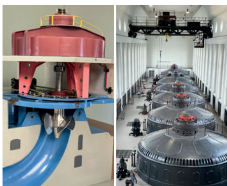
Die Kaplan-Turbinen des Wasserkraftwerks in Eglisau.
