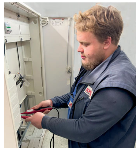
Prüfung eines Zählerplatzes für ein Mehrfamilienhaus.
