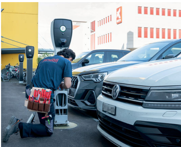
Auch E-Mobility-Ladestationen können ab sofort vom Urner Team installiert werden.
