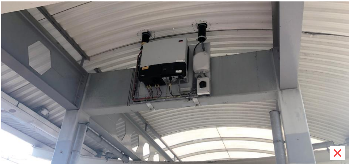
Deze installatieonderdelen bevinden zich erg in het zicht vanaf het perron. Het was beter geweest deze weg te werken in een nette omkasting of ze op een andere locatie te plaatsen waar ze minder afsteken tegen de achterliggende constructie en het dak, station Zwolle.
