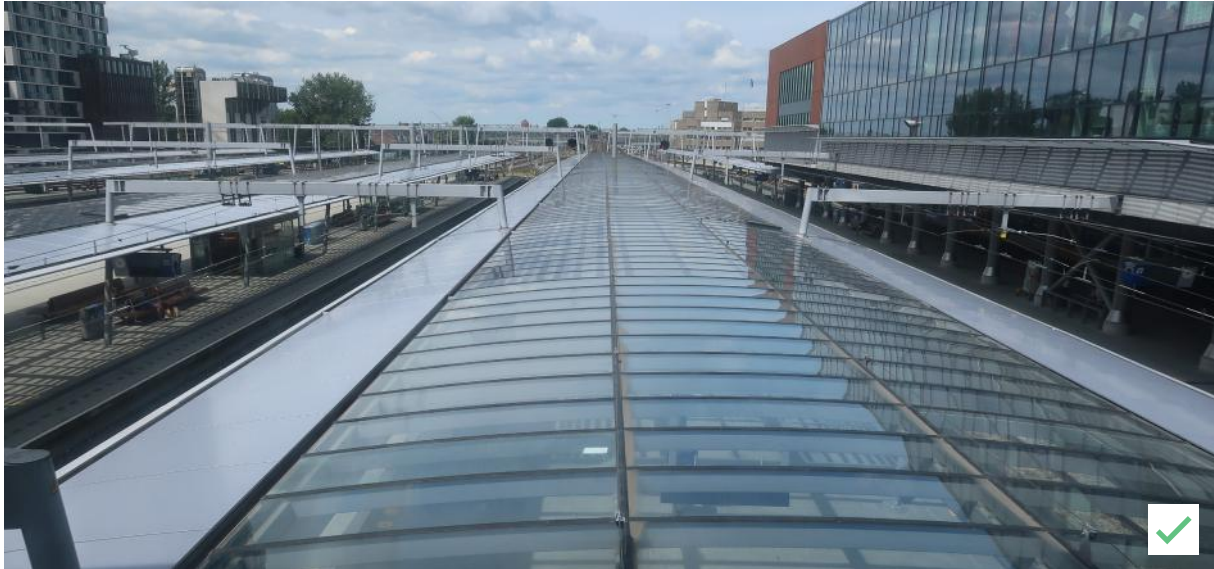
Let bij het plaatsen van bouwkundige voorzieningen en bekabeling zowel op de boven- als onderzijde van het dak. Aan de bovenzijde van de perronkappen op station Utrecht zijn geen bouwkundige voorzieningen of bekabeling te zien.
