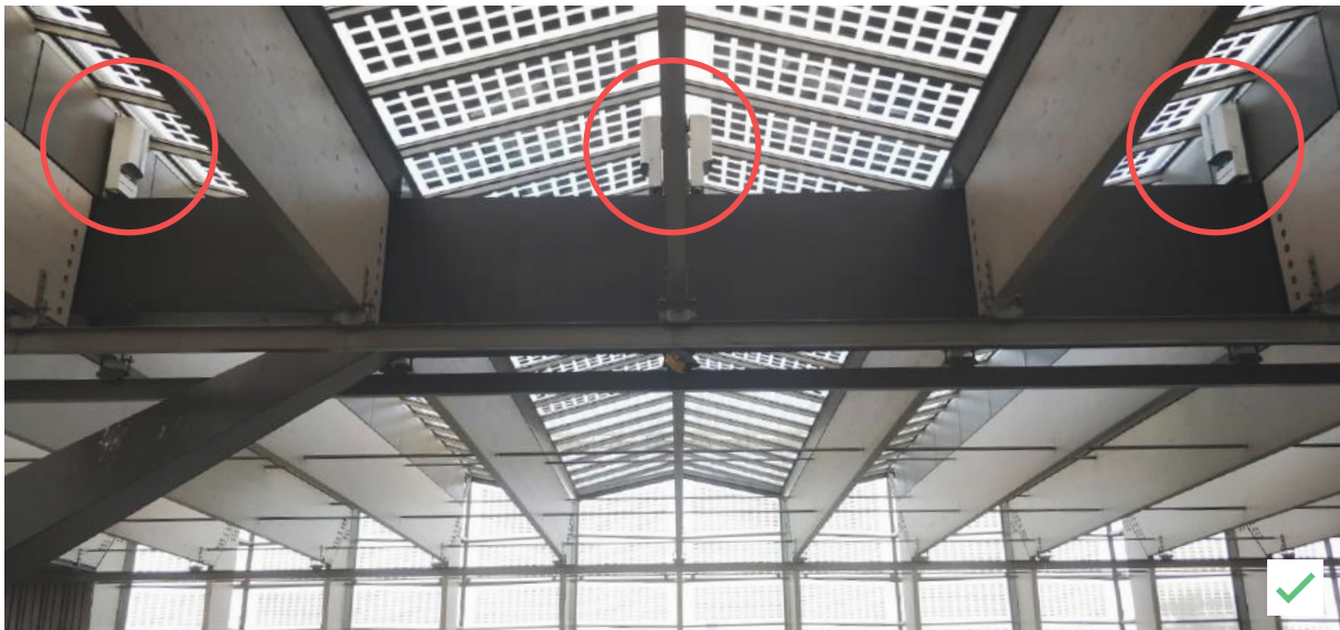
De omvormers zijn vanaf het perron niet storend zichtbaar door de positionering ter plaatse van twee elkaar kruisende balken, station Rotterdam.
