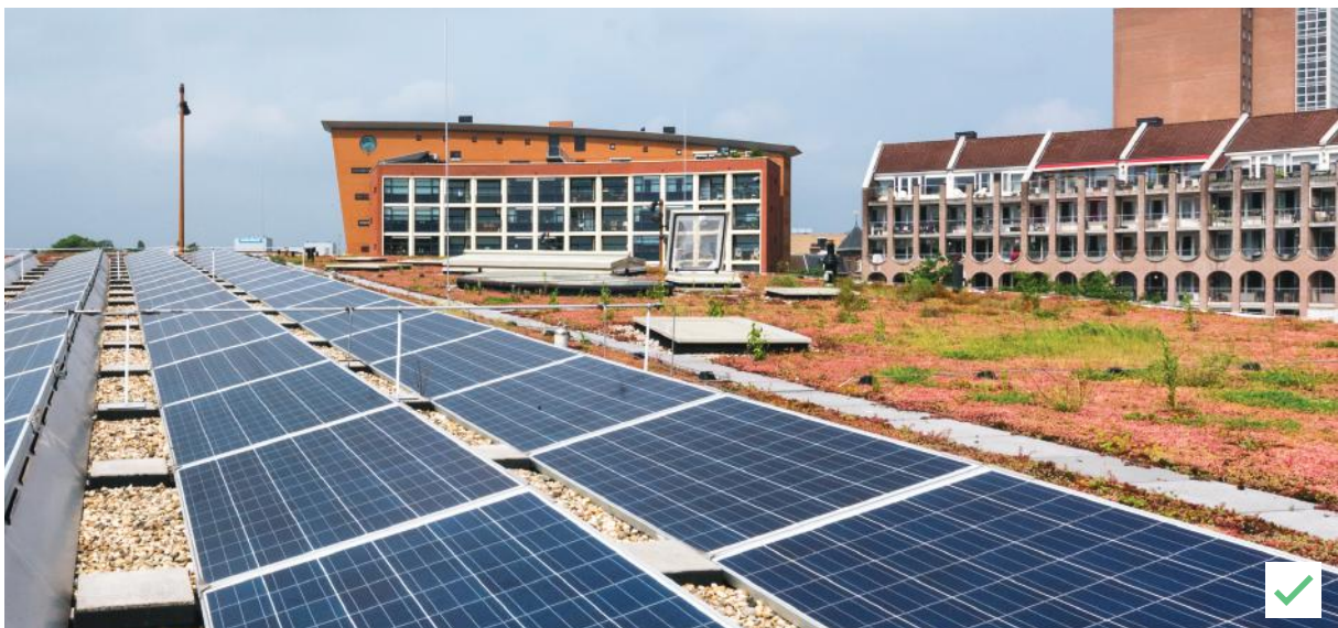
Station Helmond: De combinatie van zonnepanelen en een groendak heeft, naast een groene en duurzame uitstraling, een gunstig effect op het rendement. Dit effect was het grootst geweest wanneer de panelen verhoogd waren geplaatst en het groendak onder de panelen doorgelegd was (minder warmteontwikkeling)
