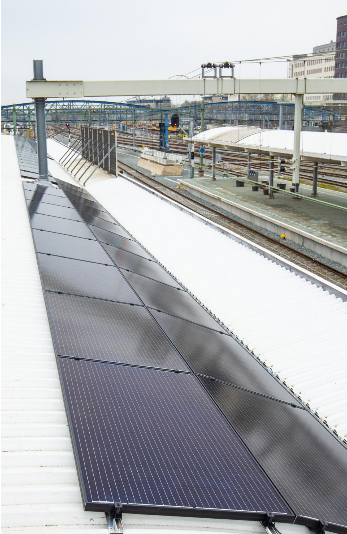
Detailfoto zonnepanelen op een perronkap; station Zwolle.
