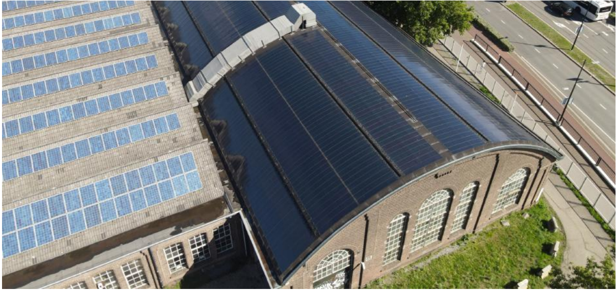
Zorgvuldig ingepaste flexibele panelen op een gebogen dak. Voorbeeld van Energie.net. Koepelhal Tilburg.
