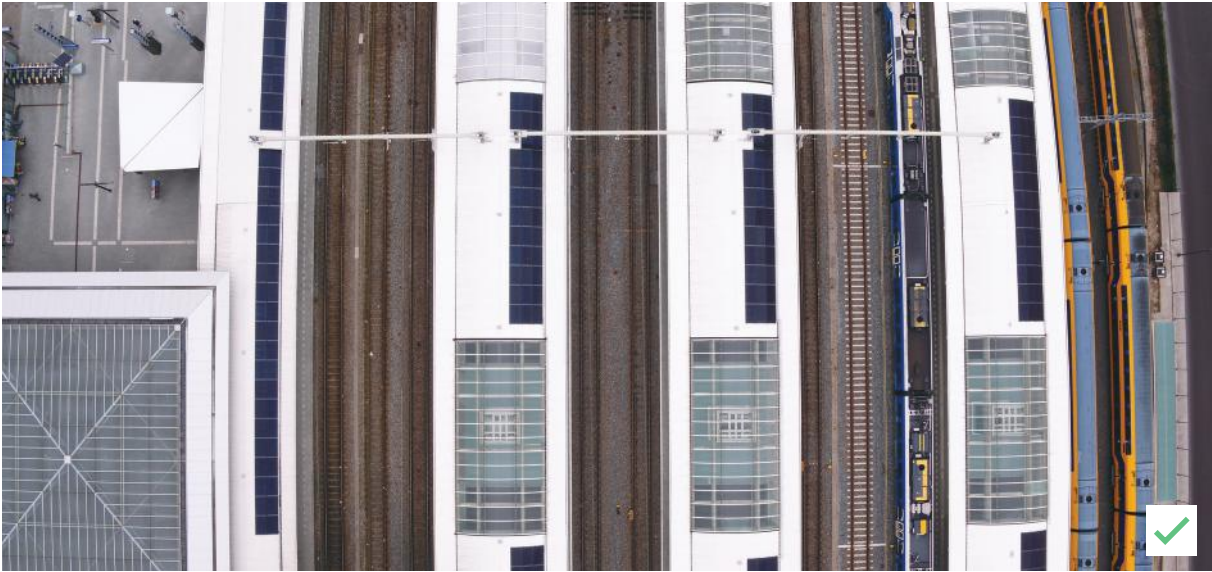
De bestaande lichte perronkappen zijn voorzien van monokristallijne panelen, station Zwolle.
