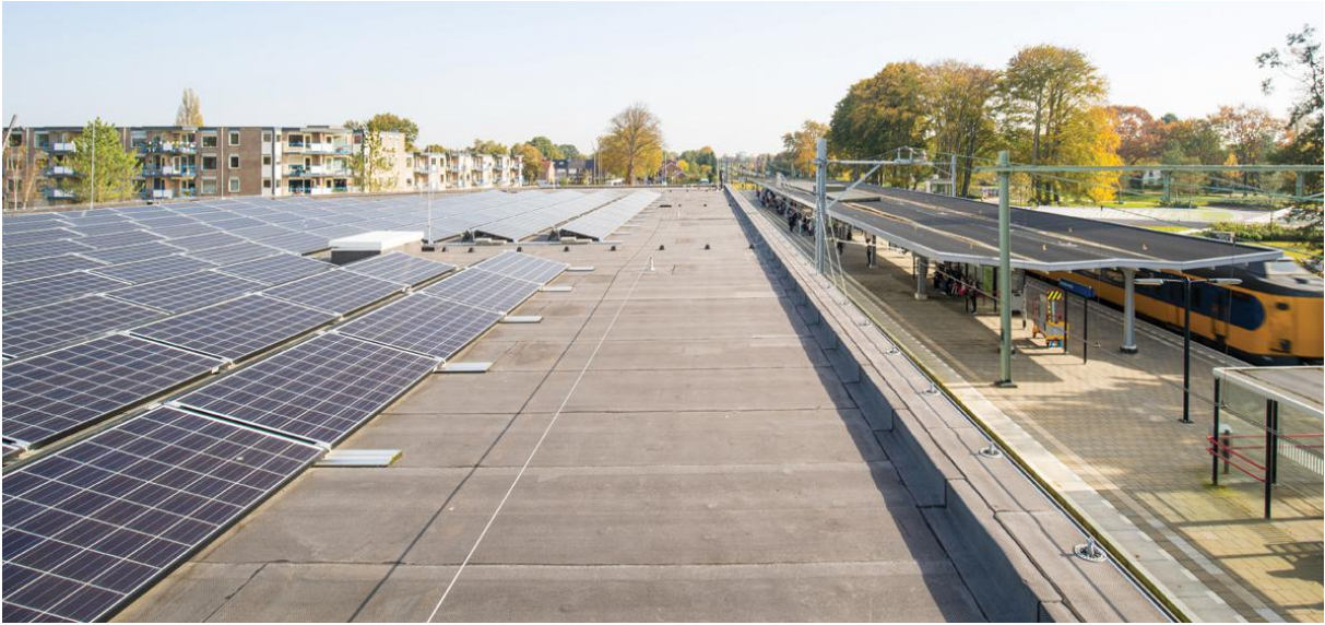
Zonnepanelen op fietsenstalling station Harderwijk: evenwijdig geïmponeerd aan de lengterichting van het dak en losgehouden van de randen. Station Harderwijk
