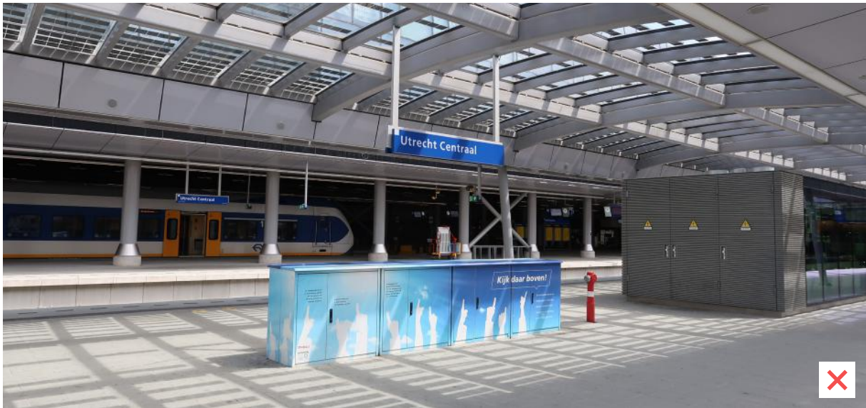
De schakelkasten en omvormers staan in de weg in het transfergebied. De boodschap op de kast is wel positief door aandacht te vragen voor de duurzame zonnepanelen, station Utrecht.
