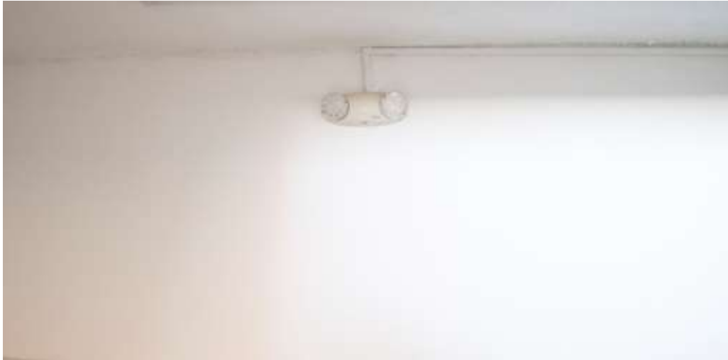
Ilustración 30. Luces de Emergencia.
