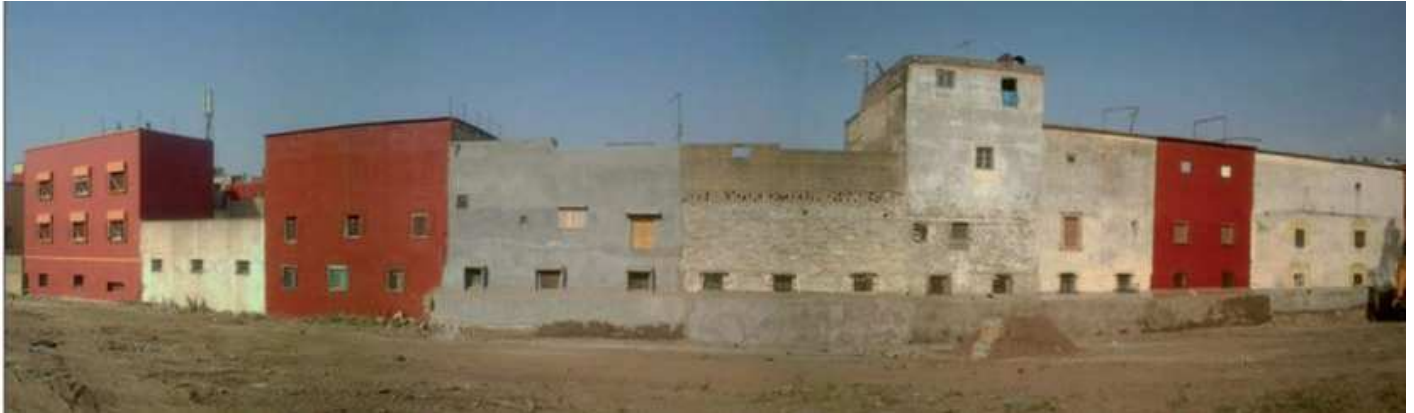
Etat des façades sur le couloir ferroviaire
