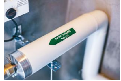
Kaukolämpöveden paluuputkessa on jäähtynyttä kaukolämpövedtä.
