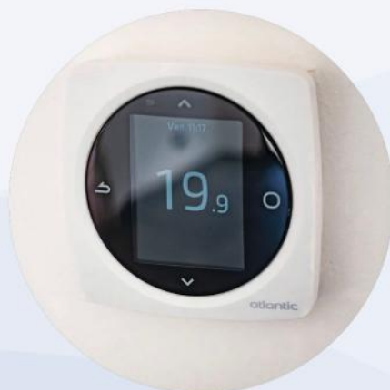
Alarme & domotique intégrées dans chaque appartement
