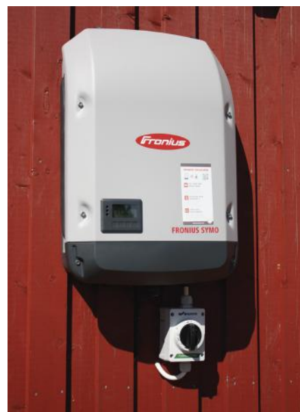
Invertteri on aurinkovoimalan sydän.
