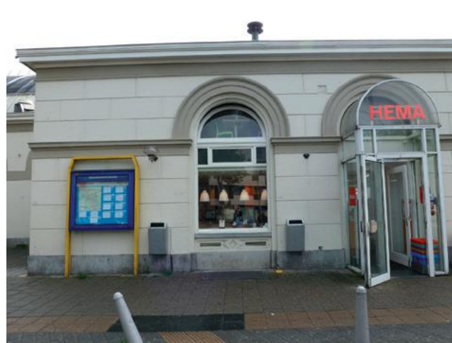
Erosie van gevelbeeld door informatieborden, straatmeubilair, en tochtportalen.
